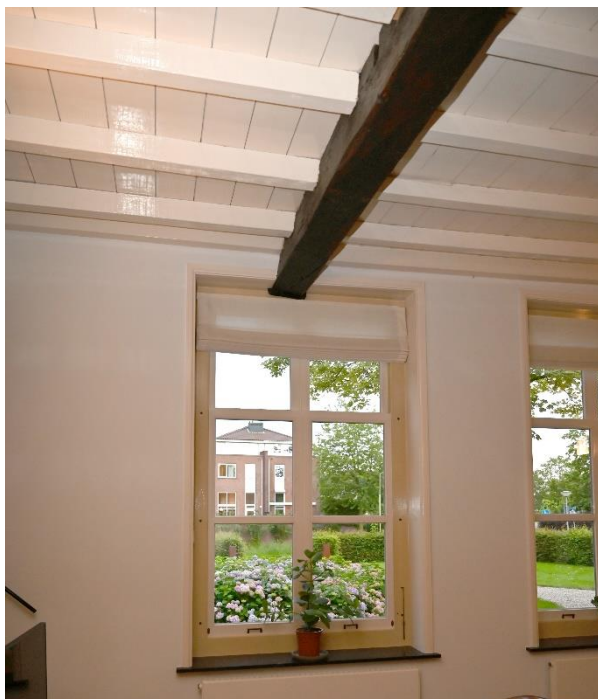
Een steunbalk die op een raamkozijn rust, vormde een uitdaging bij de restauratie (foto: Suzanna Kolenbrander)
