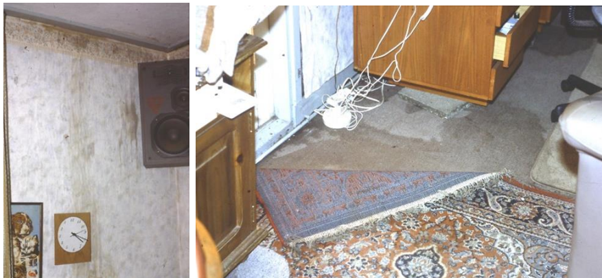
Waterschade tijdens de renovatie
